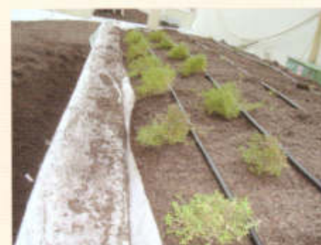
Impianto di irrigazione ad ala gocciolante, messa a dimora della vegetazione e pacciamatura con lapillo vulcanico, per ottenere un raccordo più naturale tra i cordoli e le aiuole sui bordi sono stati posizionati
